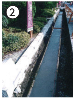
② ベースコンクリート打設 ※ベースコンクリートは、CDレーン 下面から2cm程度下げて打設します。
