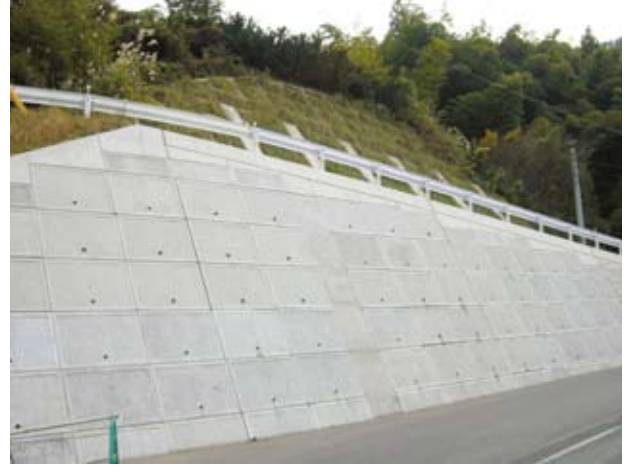
福岡県八女市:標準ブロック(かさね積みもたれ式擁壁)
