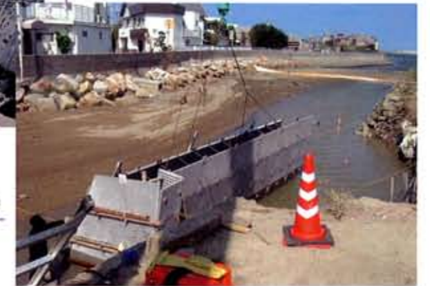
「兵庫県」 洲本土木事務所 三原川水系柿ノ木谷川河川災害復旧工事 (水中コンクリート施工) (ピアスタイプ、事前組立)
