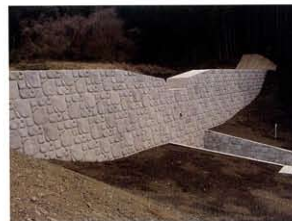
「栃木県」 鳥山土木事務所 国庫補助通常砂防工事入郷沢 (メーク玉石オリジナル)
