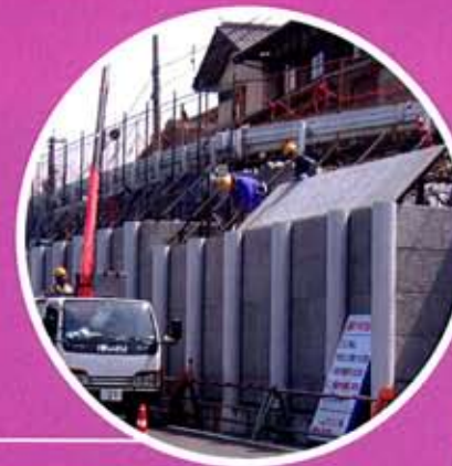
「滋賀県」 近畿地方整備局滋賀国道事務所 21号米原地区構造物補修工事(FCB工法) (メークハツリ面)(メークハンガーシステム)
