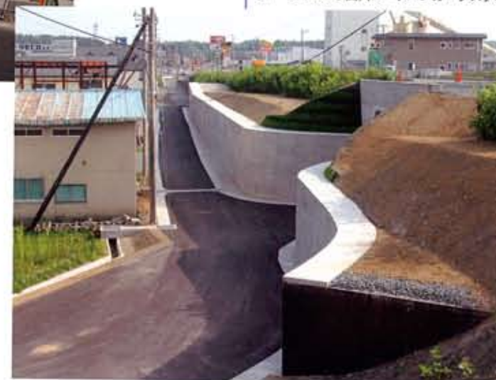
「岩手県」 東北地方整備局岩手河川国道事務所 鬼柳道路改良工事 (FCB工法) (メークハツリ面) (メークハンガーシステム)
