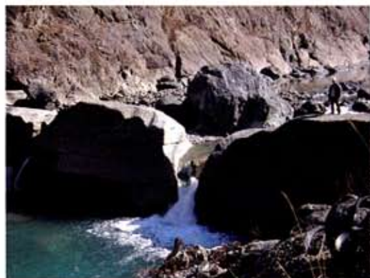
「現場付近の床固工被災状況」
