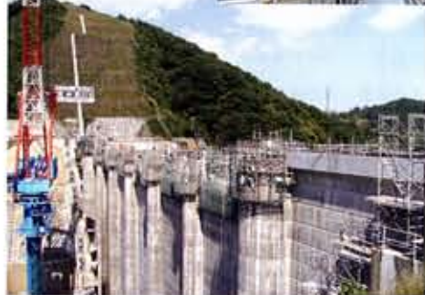
「兵庫県」 神戸土木事務所 石井ダム建設工事 (メークハツリ面オリジナル)
