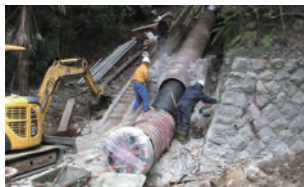
▲水力発電管路(水圧管)
