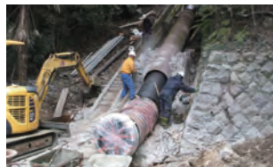
▲水力発電管路(水圧管)
