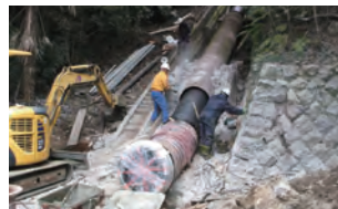
▲水力発電管路(水圧管)
