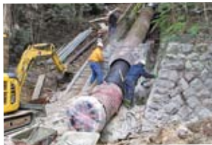
▲水力発電管路(水圧管)
