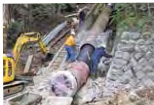
▲水力発電管路(水圧管)
