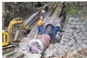
▲水力発電管路(水圧管)
