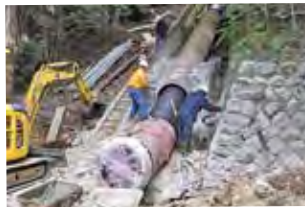
▲水力発電管路(水圧管)
