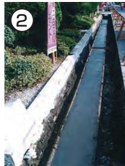
② ベースコンクリート打設 ※ベースコンクリートは、Cドレーン 下面から2cm程度下げて打設します。
