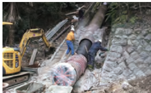
▲水力発電管路 (水圧管)
