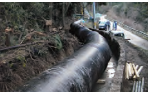
▲上水道管 (誘導管)
