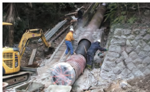
▲水力発電管路(水圧管)
