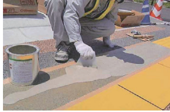
5. 専用接着剤の塗布・上塗り 2の手順で再度接着剤を混合攪拌し、専用のクシ目ゴテでムラなく均一に塗布します。
