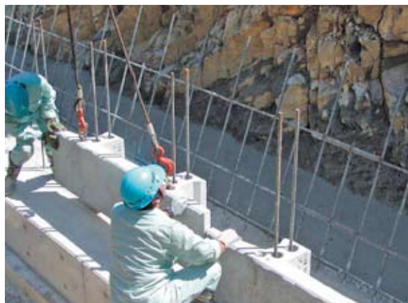
④フロントブロック敷設 (吊り金具の採用で施工が安全かつ早くなります。)
