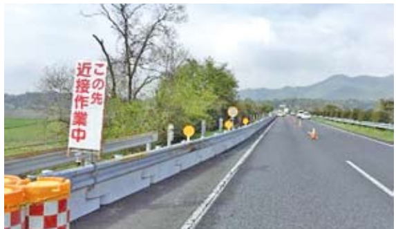
▶置き式使用(城南スマートインター付近)
