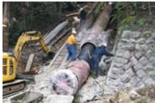
▲水力発電管路(水圧管)
