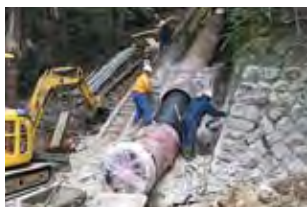
▲水力発電管路(水圧管)
