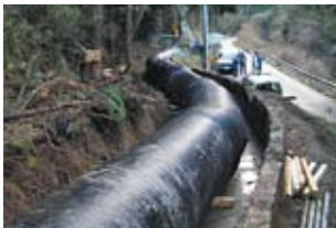
▲上水道管(誘導管)
