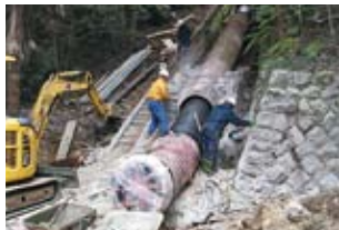
▲水力発電管路(水圧管)
