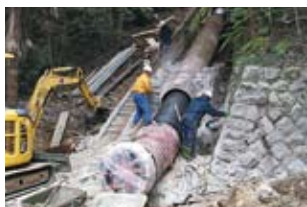
▲水力発電管路(水圧管)
