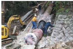
▲水力発電管路(水圧管)
