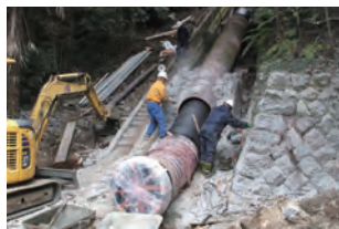
▲水力発電管路(水圧管)
