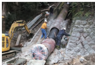
▲水力発電管路(水圧管)
