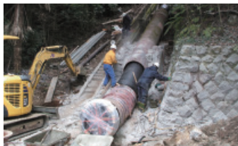
▲水力発電管路(水圧管)
