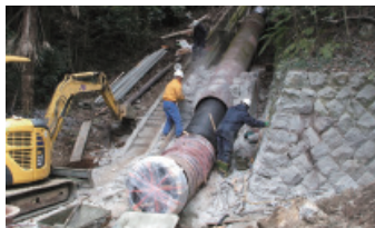
▲水力発電管路(水圧管)
