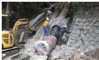
▲水力発電管路(水圧管)
