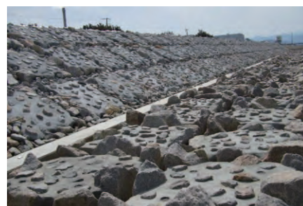
▲ 河川での設置例
