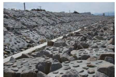
▲ 河川での設置例
