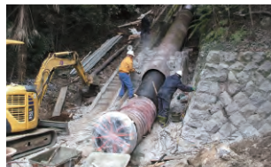
▲水力発電管路(水圧管)
