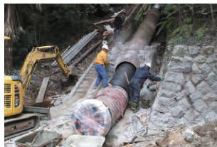
▲水力発電管路 (水圧管)
