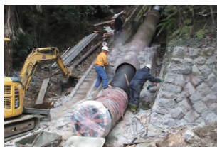
▲水力発電管路(水圧管)
