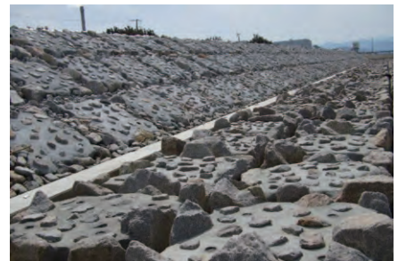
▲ 河川での設置例
