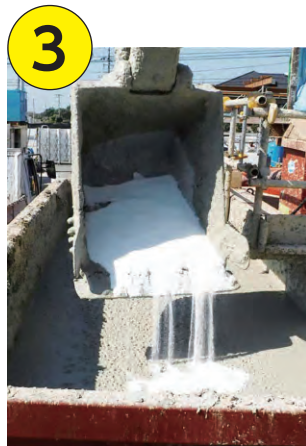
●バックホウで15分程度混合 (ドライブミキシング等を使用すると、より均一に混合することができます)
