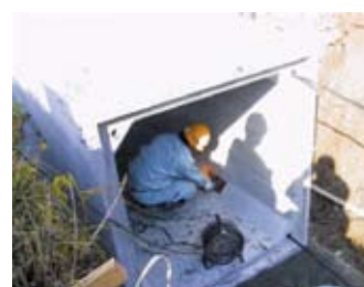
12. 最後のカップリング付ボックスの部分でPC鋼より線を定着した後、切断
