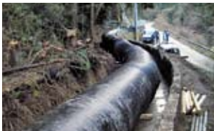
▲上水道管(誘導管)
