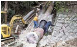
▲水力発電管路(水圧管)
