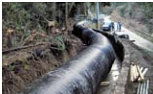
▲上水道管(誘導管)
