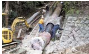
▲水力発電管路(水圧管)
