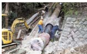
▲水力発電管路(水圧管)
