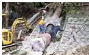
▲水力発電管路(水圧管)
