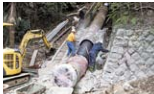
▲水力発電管路(水圧管)
