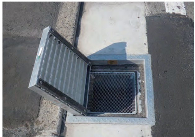
▲PU型300×300A(グレーチング開口状態)
