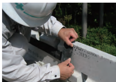
5. カサロック同士、カサロックとL型擁壁の接合部(背面側)に付属の止水テープを貼り、ボルト部をモルタルで埋めます。
