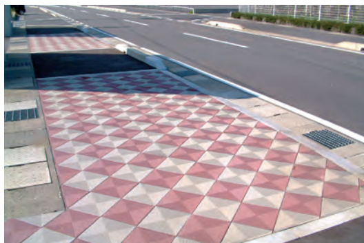
▲鹿児島県始良町(透水ユニプレーン)
