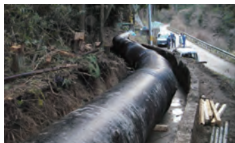
▲上水道管(誘導管)
