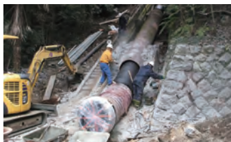
▲水力発電管路(水圧管)
