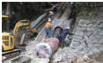
▲水力発電管路(水圧管)
