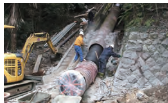
▲水力発電管路(水圧管)
