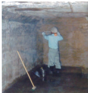
2 清掃及び採寸 藻等が躯体に付着している場合は 高圧水等で洗い流します。
