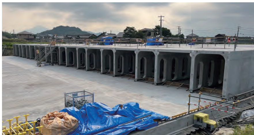
▲佐波川右岸広域防災広場 M.V.P.システム(山口インフラテック)
